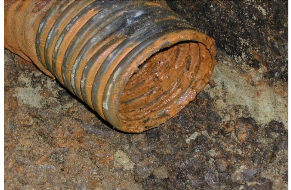
Colmatage ferrique des orifices d'un drain
